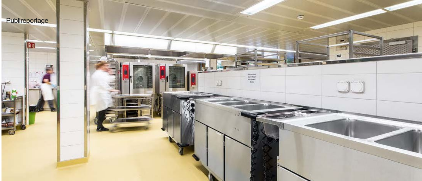
L'utilisation des systèmes de cuisson suisses et la nouvelle cuisine ouvrent de nouvelles possibilités de restauration à la fondation Solina à Steffisburg.
